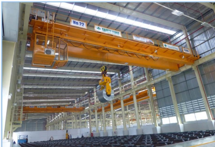
天井走行クレーン
